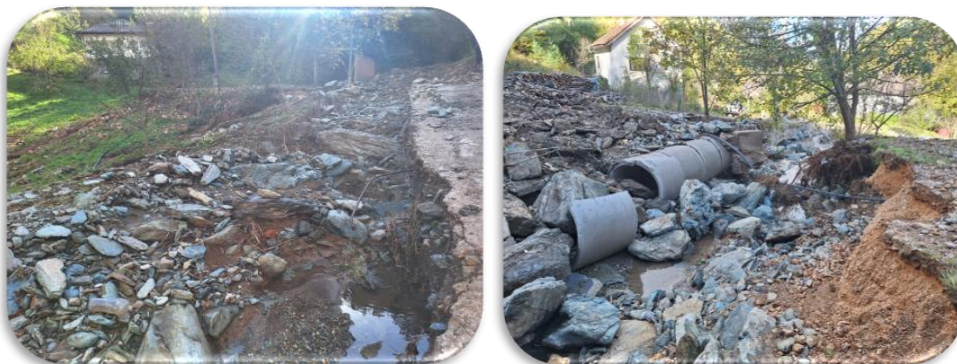
Oštećenja vodovodne infrastrukture na području općine Fojnica (Luke) (Foto: Ć. Šarić, 2024.)
