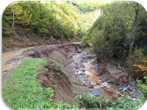
Oštećenje cjevovoda sa izvorišta „Vrtle“ (Foto: Ć. Šarić, 2024.)
