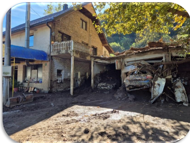
Slika 12. Neki od objekata koji su pretrpjeli oštećenja bujičnim tokom
