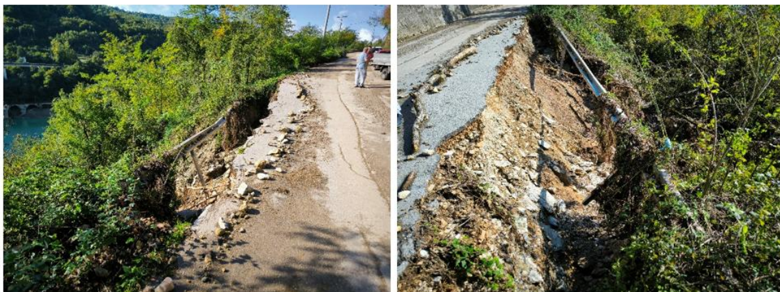
Slike 41,42 Oštećeni put
