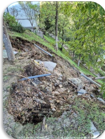
Slika 26. Klizište kod restorana Bagrem
