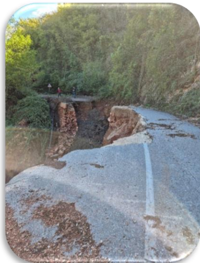
Slika 14. Regionalni put R437 oštećen bujičnim tokom
